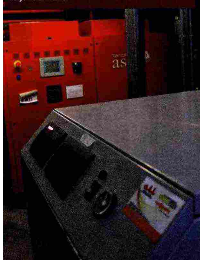
NEL LOCALE TECNICO Il microgeneratore ha potenza di 20 kW elettrici e 50 kW termici, è stata inoltre installata una caldaia di backup che entra in funzione nel caso il fabbisogno termico dell'ambiente sia maggiore di quello soddisfatto dalla cogenerazione.
